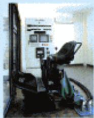
操作室及び制御室
