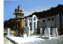
排ガス処理施設及び焼却タンク類
