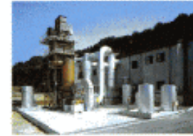
排ガスの冷却及び水噴霧タンク室
