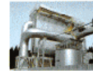
バグフィルター（平成 16年2月設置）
