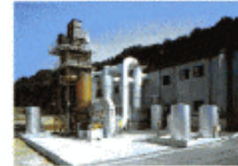
排気ガスの熱回収及び冷却タンク類
