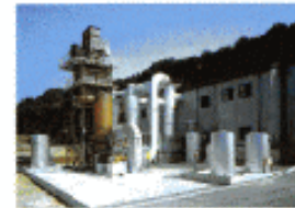
排ガスのろ過装置及び集塵タンク室
