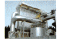
バグフィルター (平成 6年2月設置)
